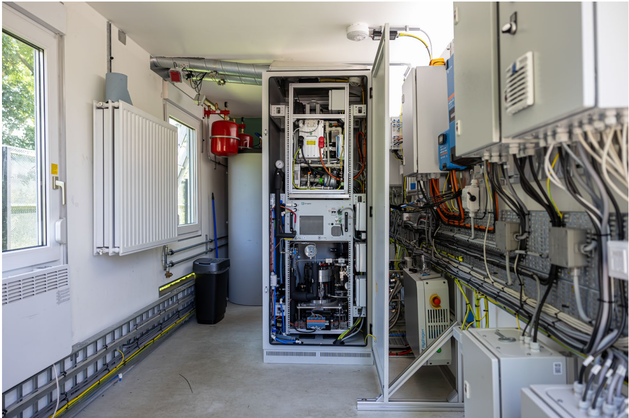
Afbeelding: binnenzijde van de 'operation room' met de elektrolyser, compressor en brandstofcel (foto Robert Kroonen)
