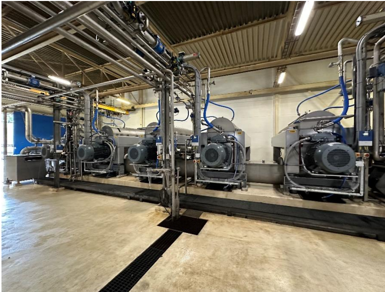
Figuur 1:Foto van de installatie
