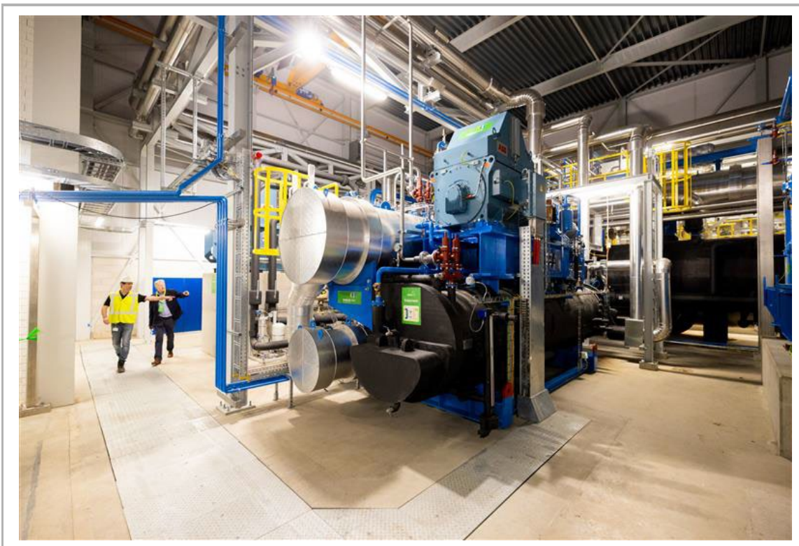
Figuur 3.1: lage temperatuur warmtepomp Holland Malt Eemshaven
