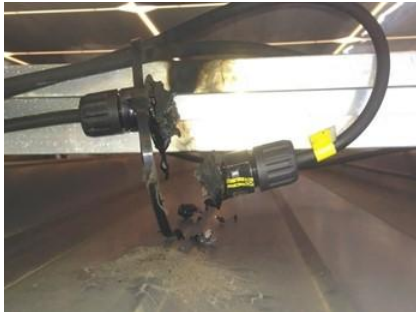
Figuur 3. Voorbeeld van een gesmolten stekker verbinding.
