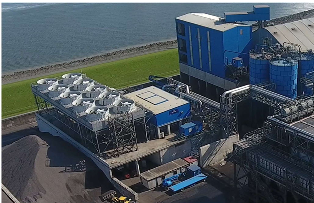
Afbeelding 1: ORC installatie zoals gerealiseerd m.b.v. de VEKI subsidie op de locatie Eemshaven van Theo Pouw Secundaire Bouwstoffen BV
