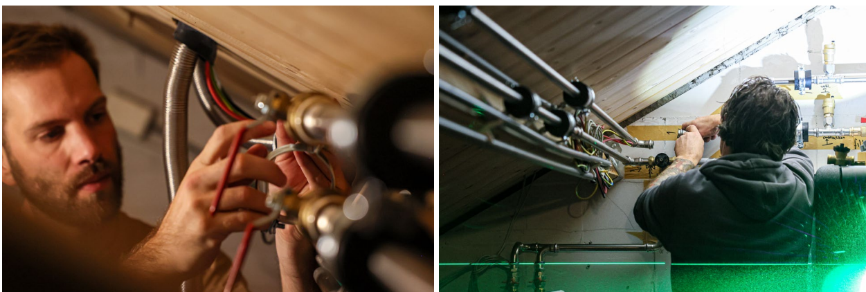
Foto's: medewerkers van Triple Solar aan het werk met de installatie in de woning (fotografie: Robert Kroonen)
