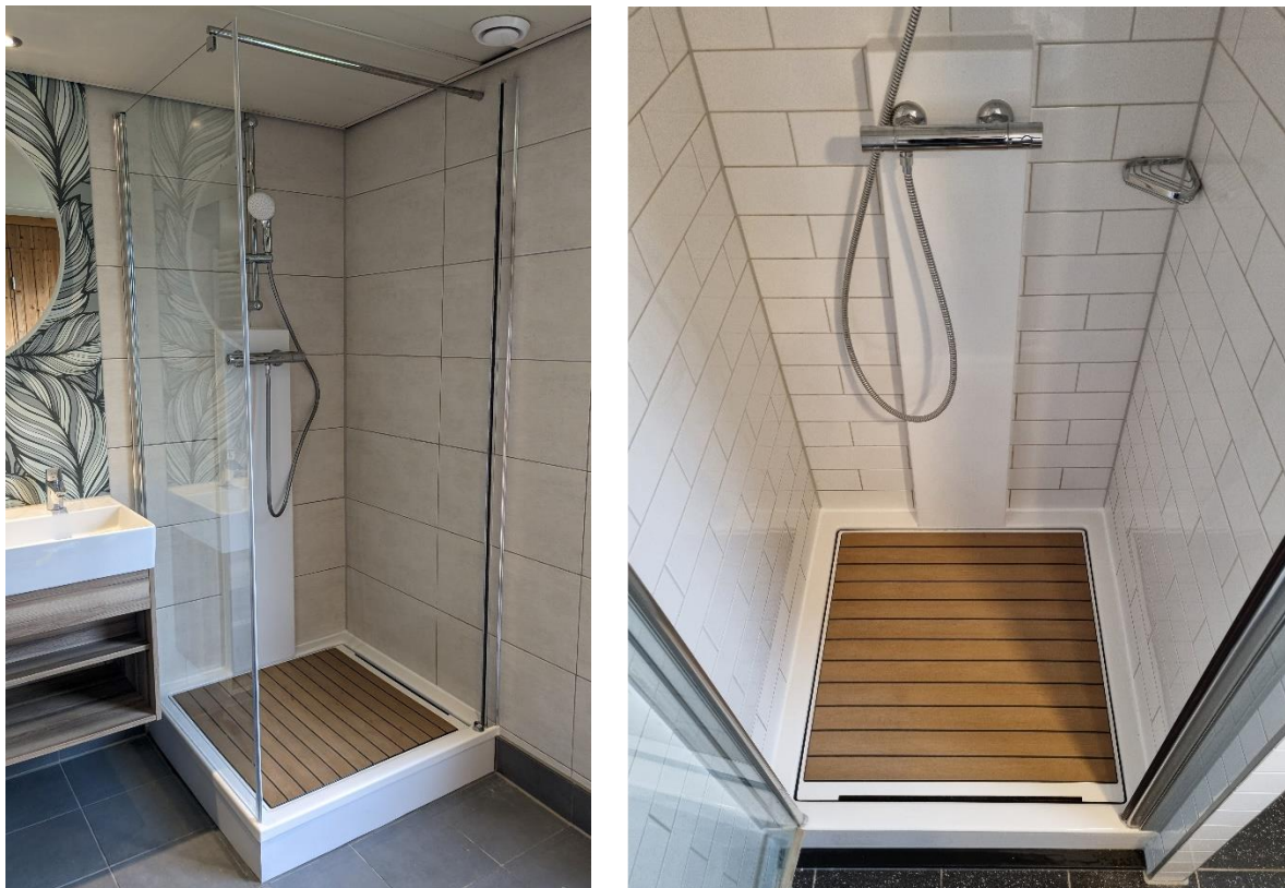
Figuur 11 – Geïnstalleerde X-Trays in vakantiewoningen van Center Parcs
