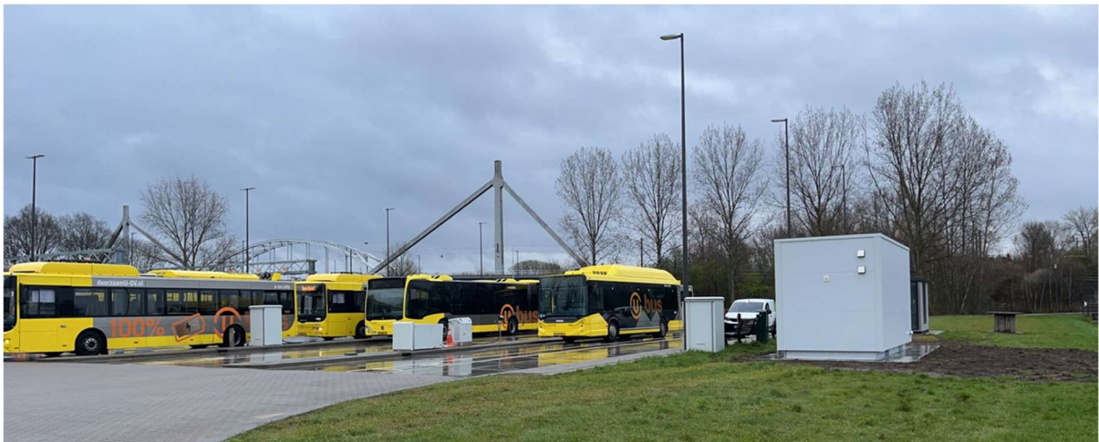
Figuur 16: Refurbished batterij op laadremise voor e-bussen van Qbuzz in Utrecht.
