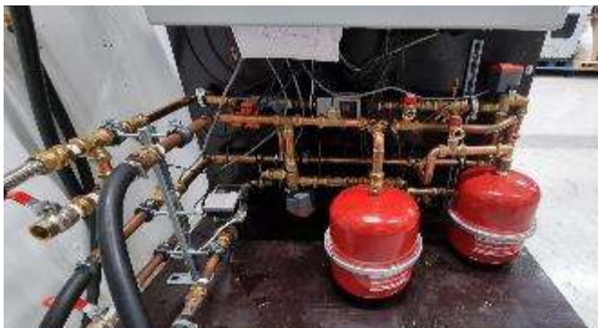
Figuur 70 Installatie voor de TCES
