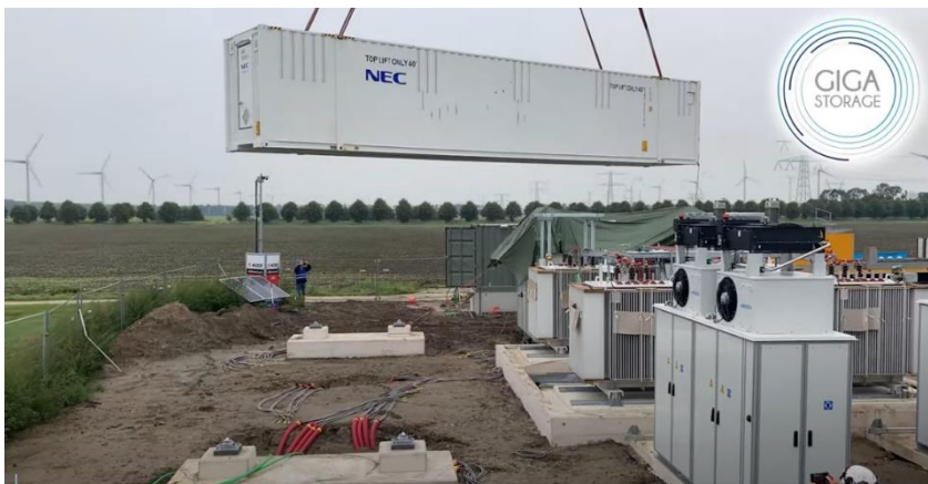
Figuur 3.1 - Plaatsing batterijcontainers
