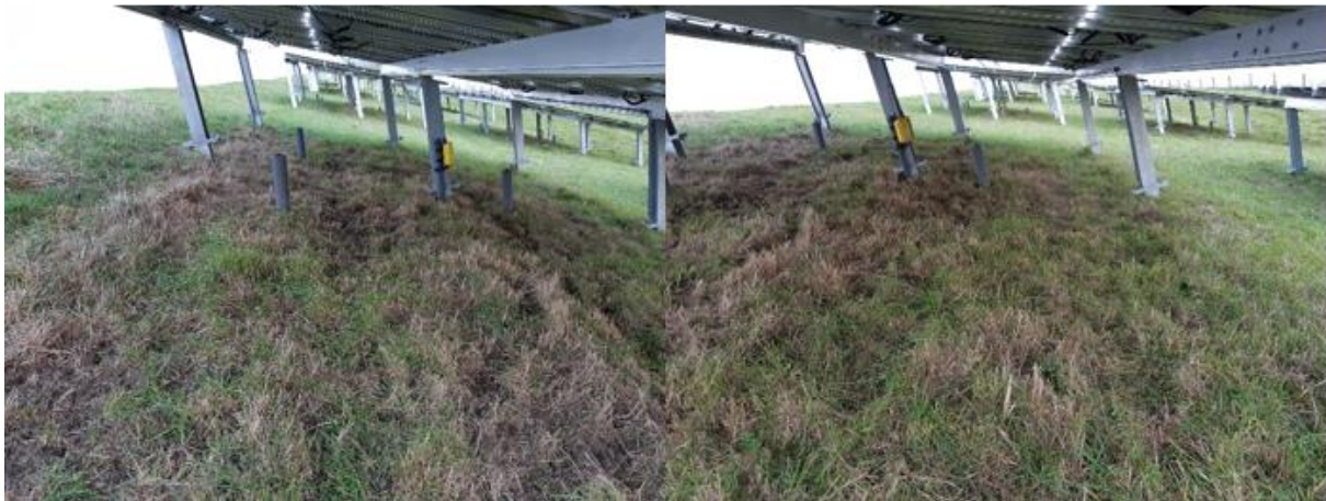
Figuur 11 Beschadigde graszode onder een PV-tafel
