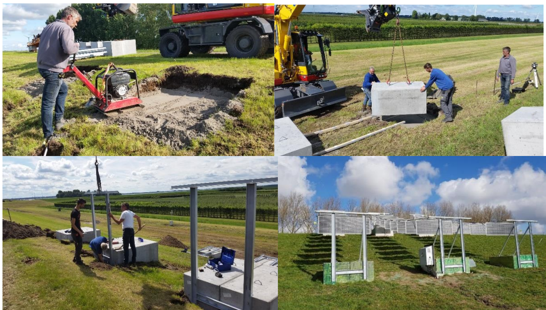
Figuur 6: Foto's tijdens de bouwfase van het Soltronergy PV-systeem op de Knardijk.
