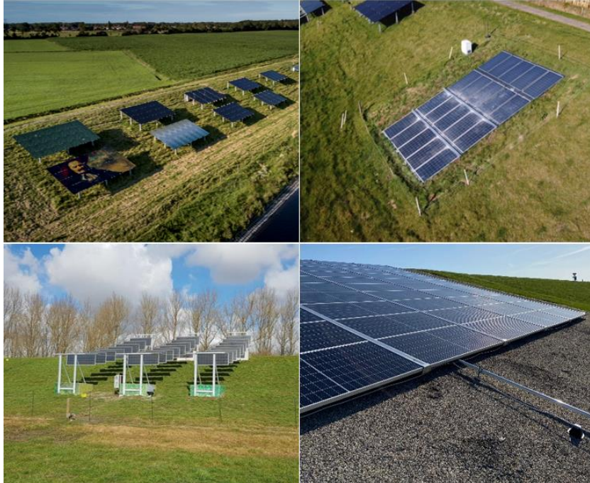
Figuur 9: Overzicht van alle 4 de PV-systemen: TNO-Eurorail (linksboven), Delmeco (rechtsboven), Soltronergy (linksonder) en Afvalzorg (rechtsonder)
