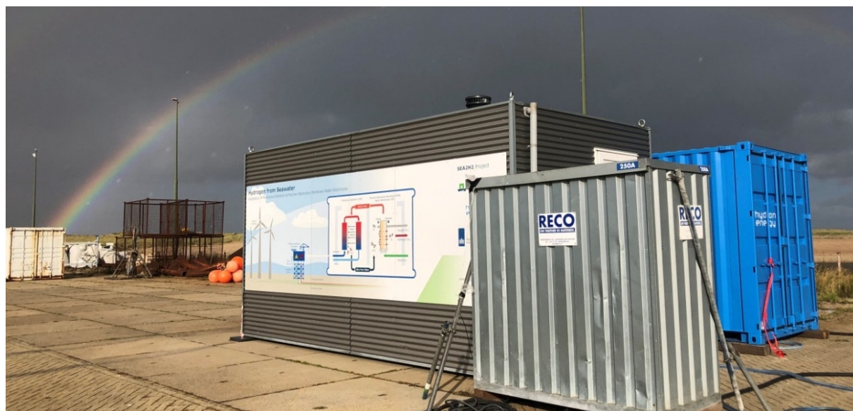
Figuur 7: Visual op de MD-container, de stroom verdeelkast (grijze RECO-container) en op de achtergrond de blauwe container met de PEMWE installatie
