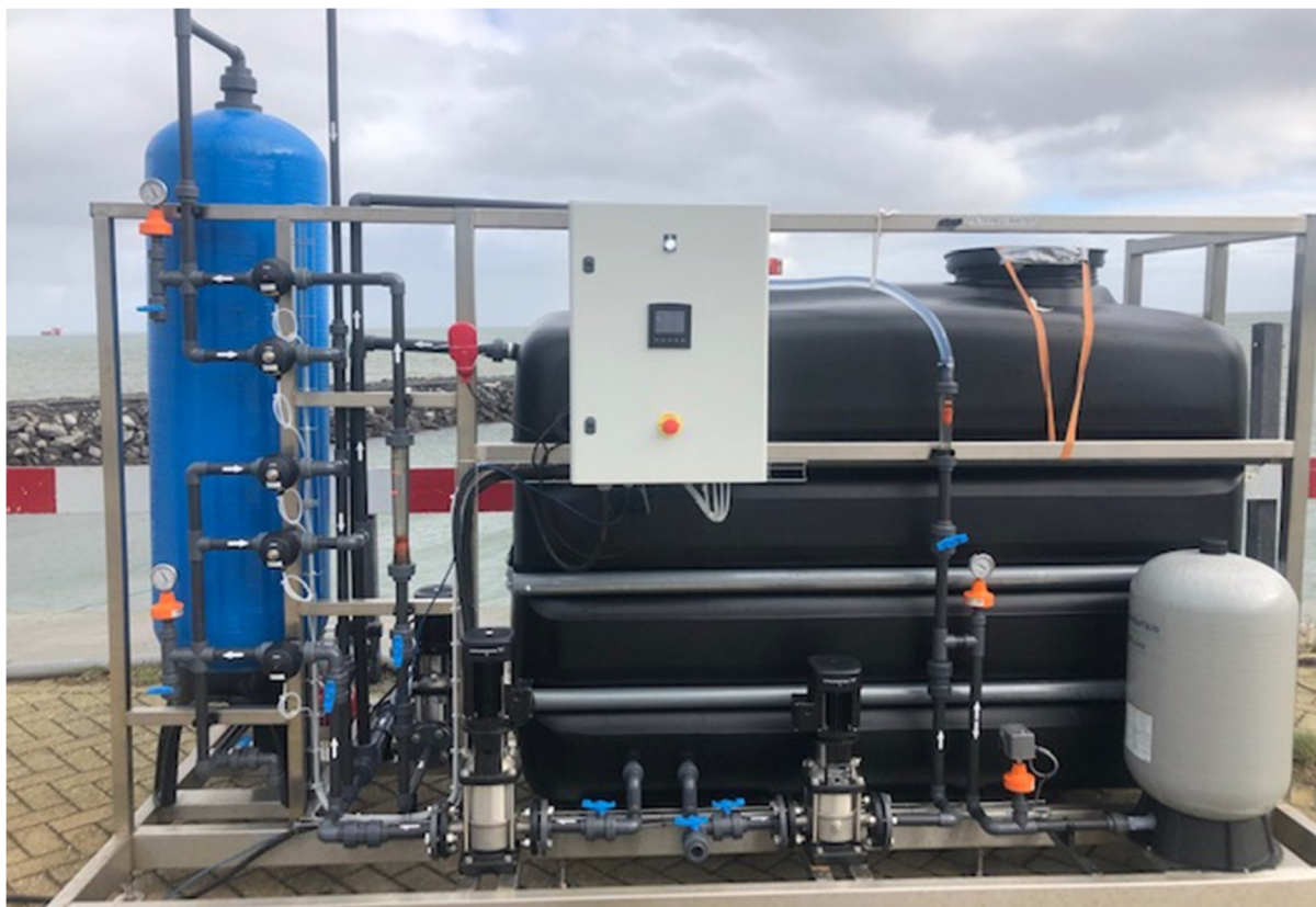
Figuur 4: Seawater intake zoals geïnstalleerd op kade van Seaport Texel, met het zandfilter (blauw), 3000 liter buffervat (zwart) en automatische kleppen (oranje). Voorzien van touch screen voor de bediening
