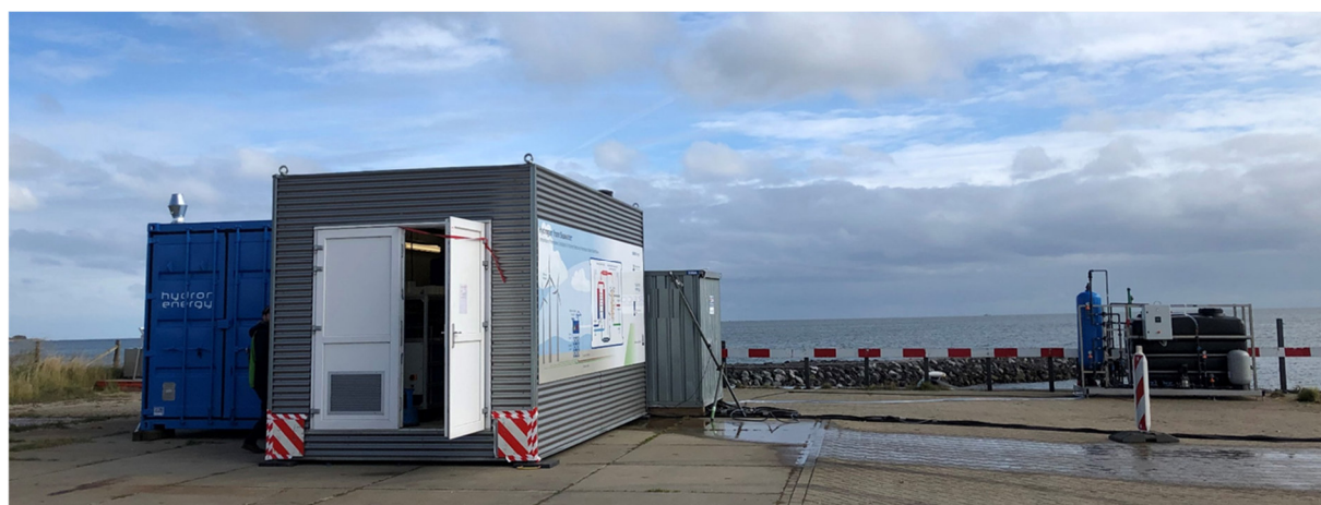
Figuur 8: PEMWE (blauwe container) en MD (grijze container) installatie met rechts op de kop van de kade de geïnstalleerde zeewater intake.
