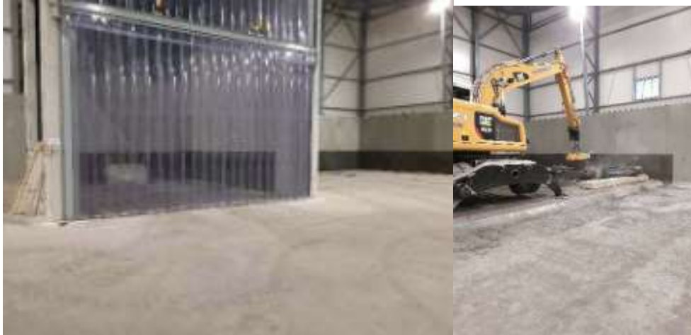
Figuur 8: Tipping box en crushing zone
