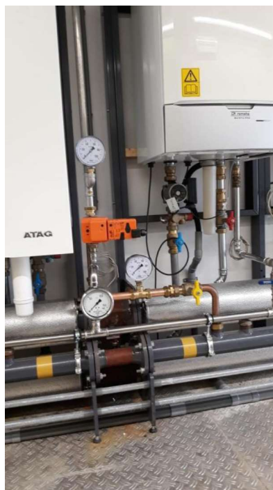
Gecontroleerde inmengklep H 2 – CH 4
