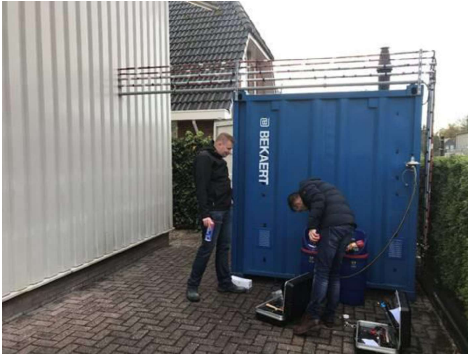
Container opstelling buiten. Twee extern opgestelde waterstof flessen.
