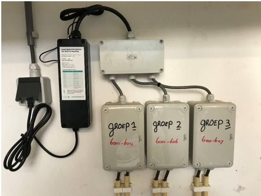
Figuur 4: Detailfoto installatie
