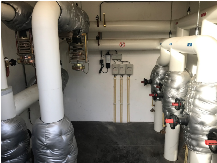
Figuur 3: Voorbeeld lekdetectie sensoren geïnstalleerd in een WOS Leidsche Rijn
