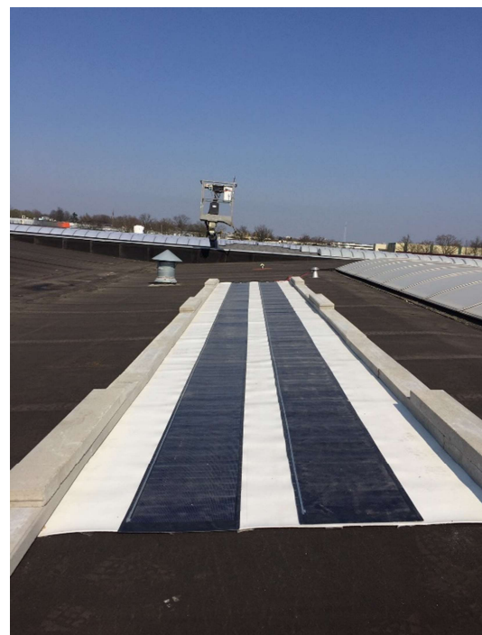
Figuur 3 : geïnstalleerd op dak
