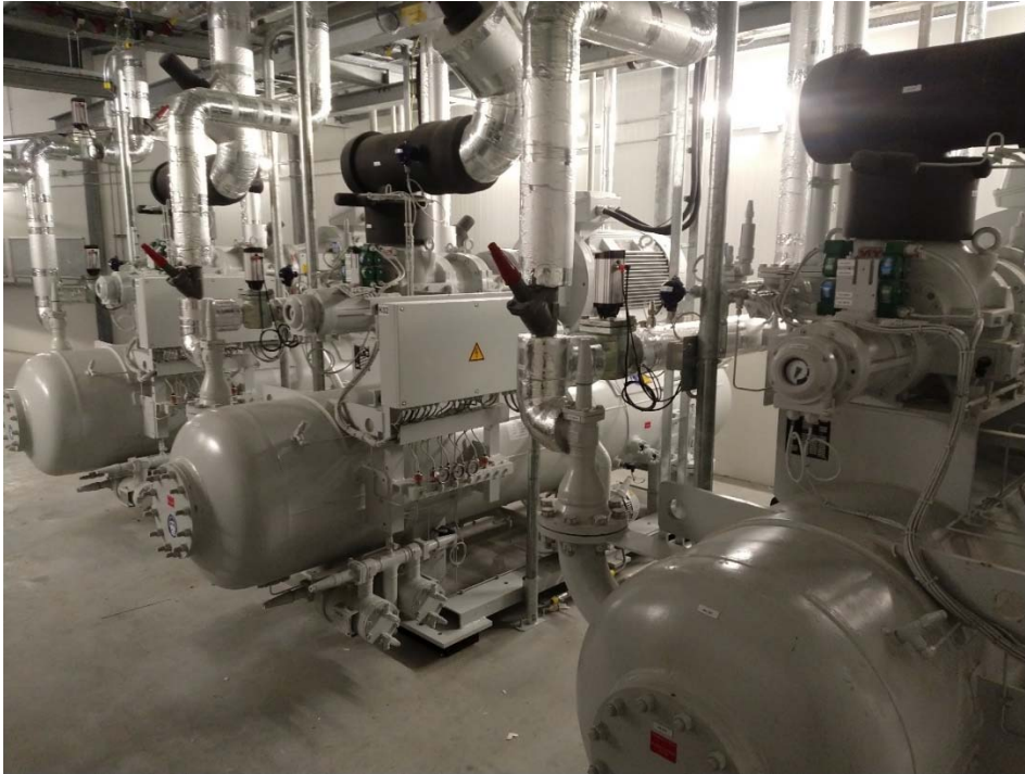
Figuur 6: Machinekamer met NH 3 compressoren centrale koelinstallatie
