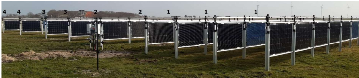
Figuur 4.5 Foto van het verticale zonne-teststelsel in Petten
