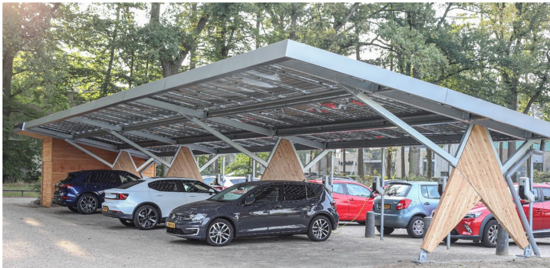
Figuur 1 Het SLIMPARK Living Lab op de campus van de Universiteit Twente in Enschede
