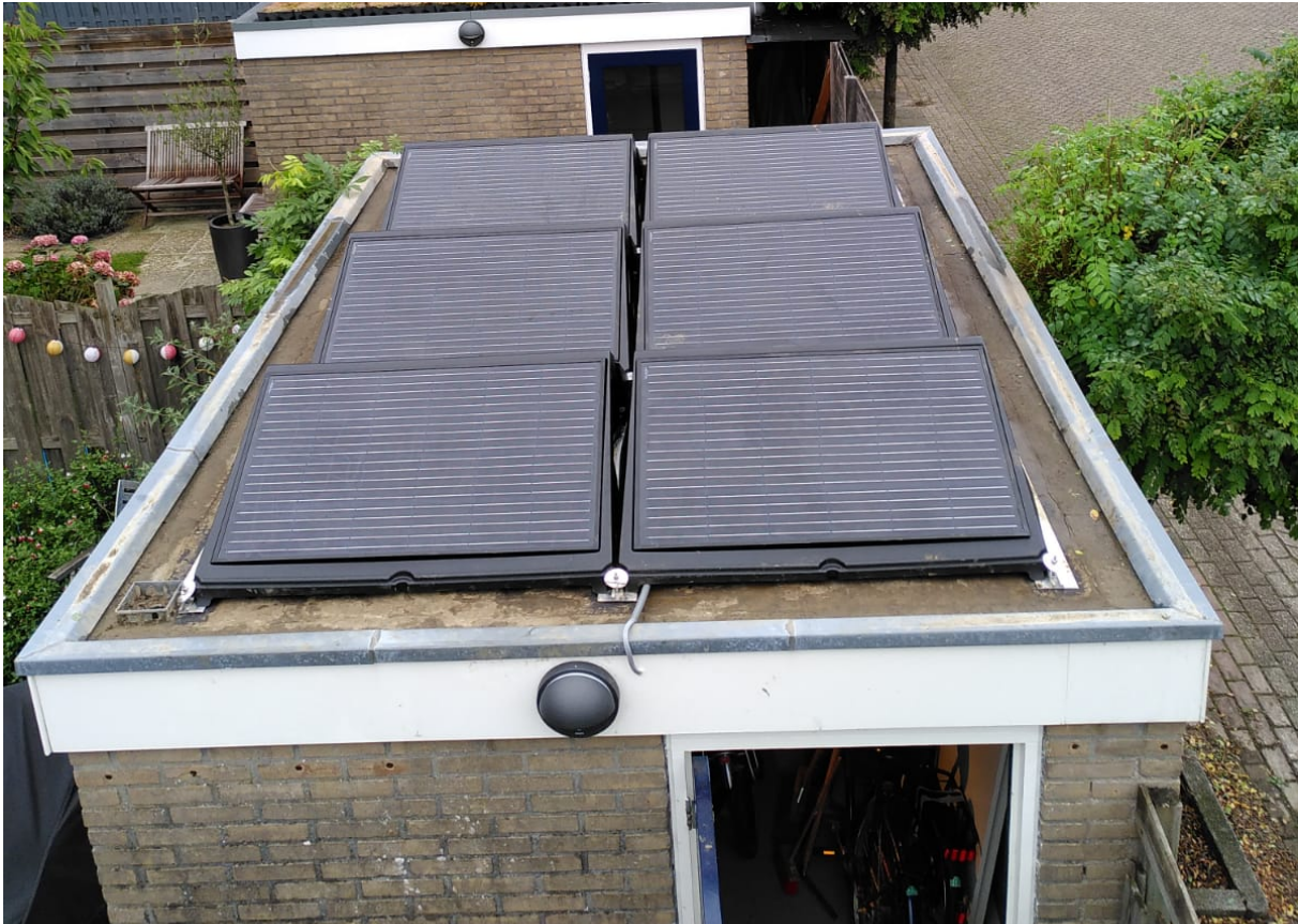
Afbeelding 18: Pilotproject met CS140 modules geïnstalleerd bij een klant.
