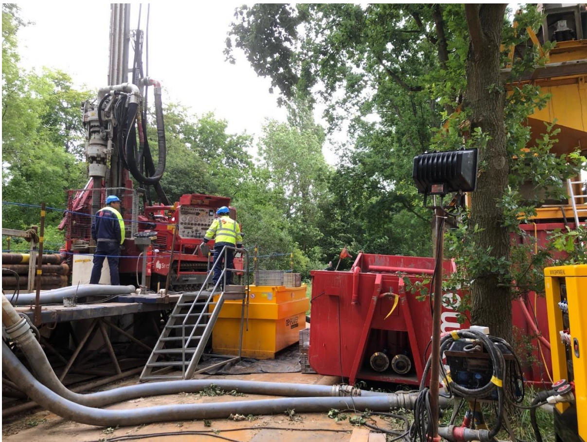
Figuur 3-2. Voorbeeld van een verhoogde opstelling van de boorinstallatie en de mantelbuis tijdens een zuigboring.
