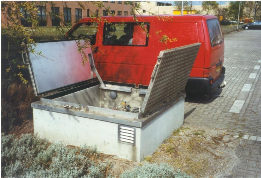
Figuur II-2 Afwerking bron met half-bovengrondse putbehuizing
