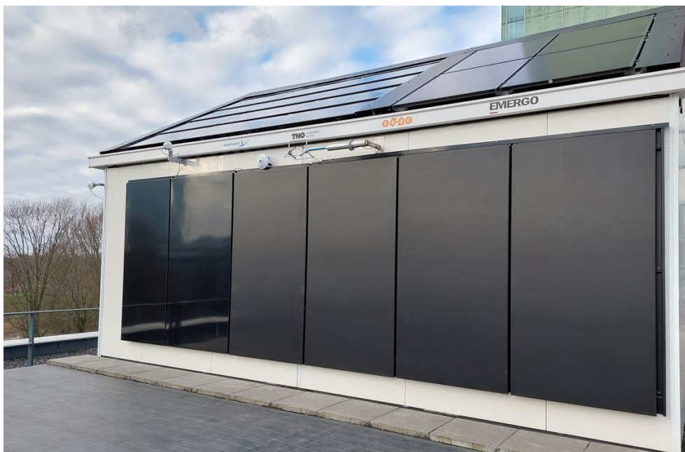
Figuur 4: Nieuwe IWP-facade collectoren (6 stuks) gemonteerd op Cabin 6 van SolarBEAT.
