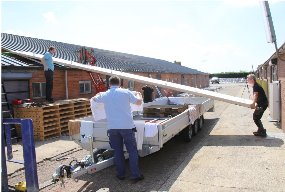
Figuur 9: Bestaande dakplaten worden gedemonteerd en vervoerd naar een schuur waar ze worden omgebouwd tot PVT-panelen.
