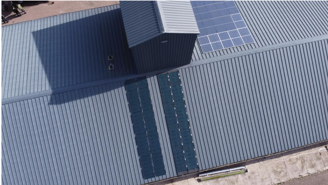
Drone shot vlak voor het middaguur wanneer het STAL-systeem op het onderste dakvlak (West-georiënteerd) uit de schaduw komt van de hoge opbouw. Links 2 PV-panelen en rechts 2 PVT-panelen.
