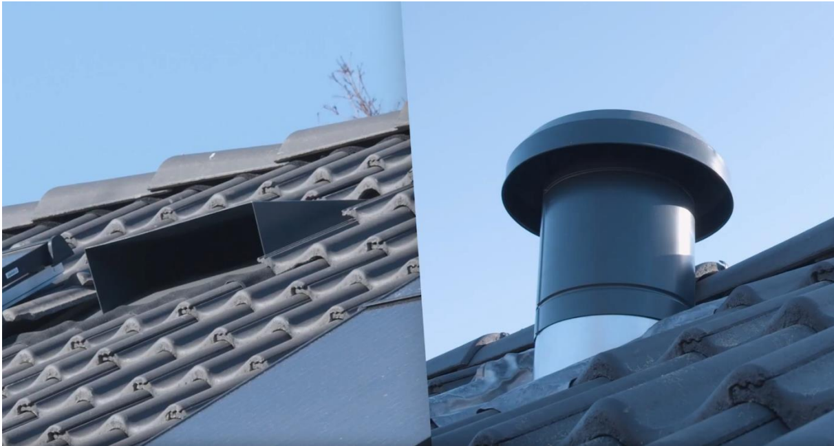
Figuur 2: Dakdoorvoeren woning Tilburg (links toevoer, recht Afvoer)
