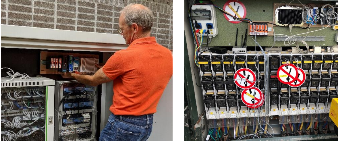
Figuur 2: Flexcore POC systeeminstallatie [in veilige status] op het ElaadNL terrein in Arnhem (Links), en in een Enexis wijkstation in Groningen (Rechts)
