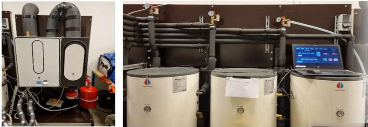
Figure 5: Warmtepomp (links) en buffervaten (rechts)
