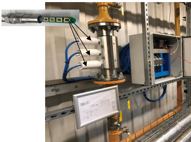
Figuur 3 - Drie sensoren geïnstalleerd op de veldtest locatie
