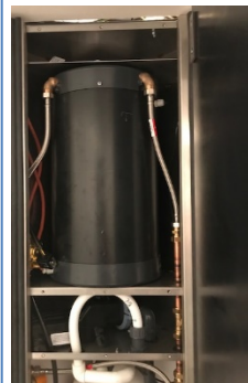
Boiler geplaatst in RVS kolom
