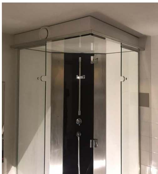
Figuur 9 GroenWest, 'loos' ventilatieventiel in afwerkplint.
