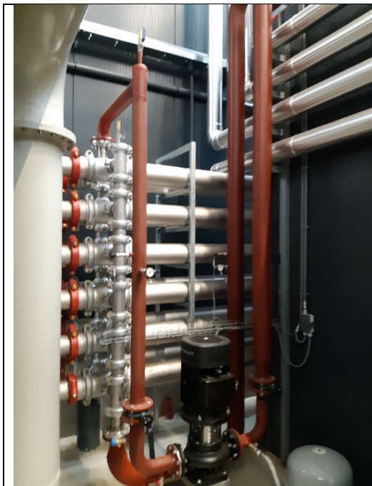
Afbeelding 6: Byosis Gas Cooler / Condensor met koelwater aansluitingen en circulatiepomp.
