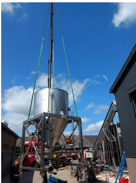
Foto 3 plaatsing van de stalmestverwerker
