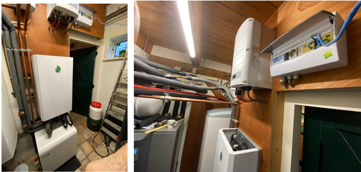
Figuur 2.1 – Test locatie Zoetermeer met PicoEnergy warmtepomp onder, Prototype prefab hydraulische verdeelunit er boven, daarboven de PV omvormer en rechtsboven de FP4All data monitoring box.
