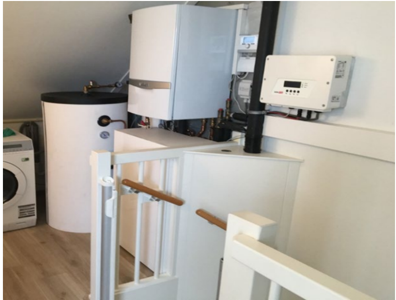
Figuur 1.4 – Eerste installatie met 3 KW warmtepomp Vaillant
