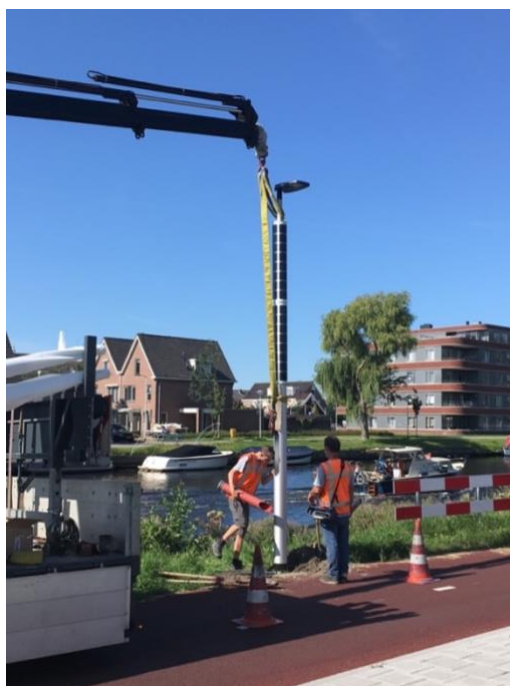
Figuur 1: Plaatsing van Soluxio zonnelichtmast langs het Kanaalpad Noord-Oost.
