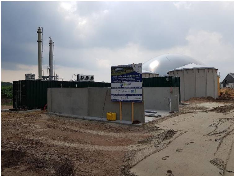
Figuur 4 Bio-Up (groene container links), Houtketel (groene container rechts), vergister(dak) (achtergrond) (achter) en opslagen.
