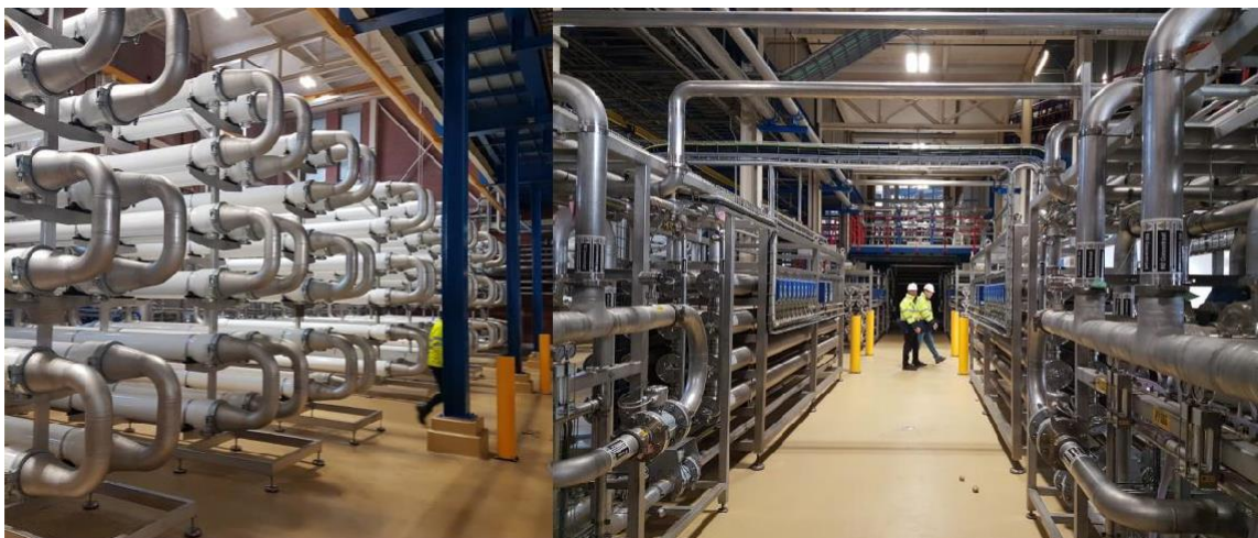
De UF membraaninstallaties
