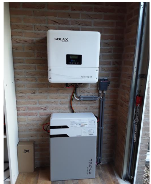
Figuur 3: Door Lyv geïnstalleerde huisbatterij
