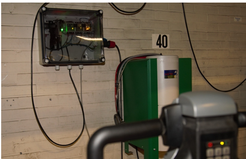
Figuur 8.22 Voorziening naast het laadstation om de laadstroom te onderbreken
