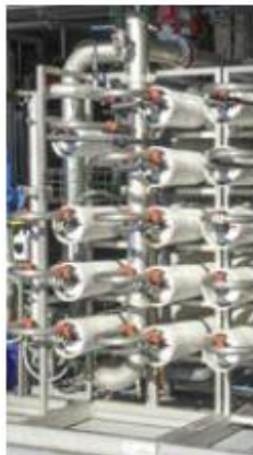
De installatie voor nanofiltratie membranen scheidt het humuszuur af
