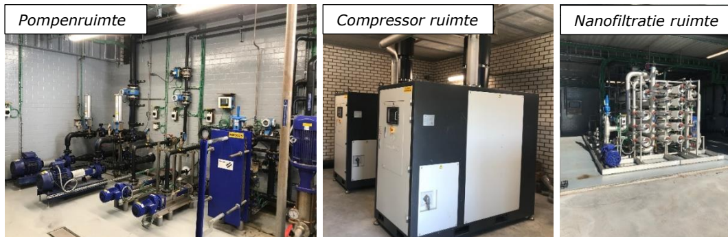
Figuur 2: Procesruimtes installatie
