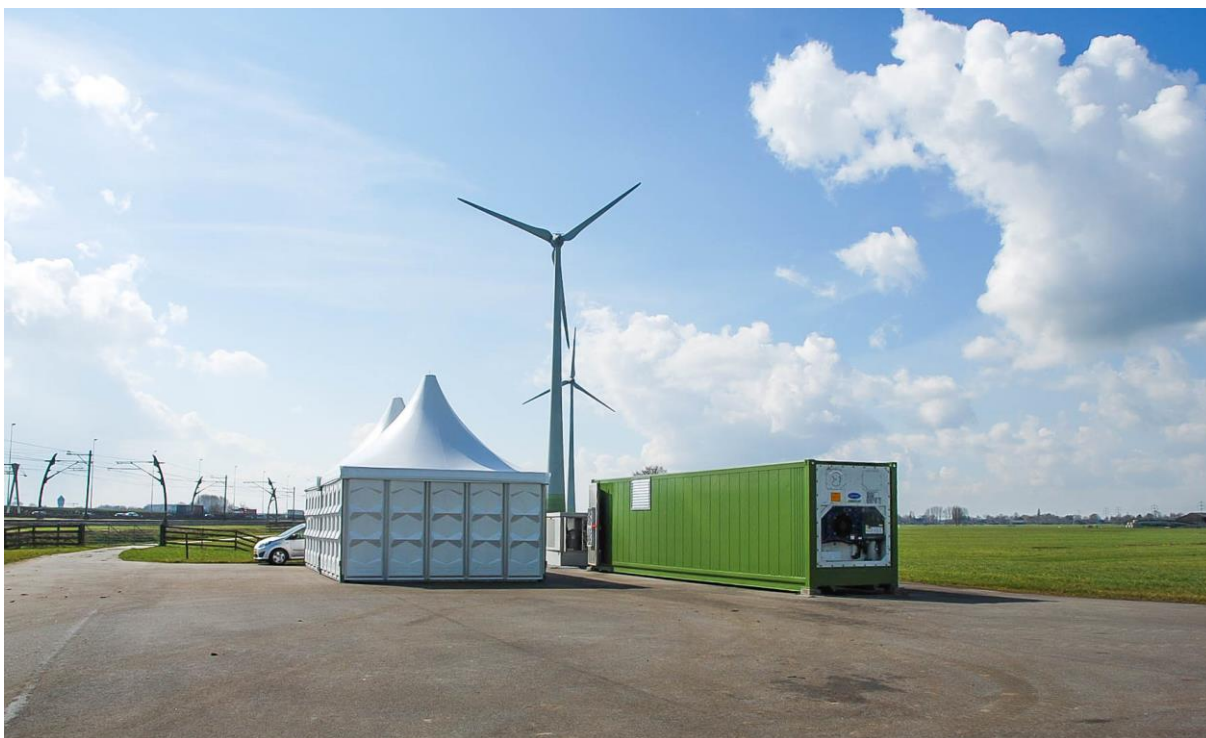
Figuur 1: fotocollage van het energieopslagsysteem bij windpark Giessenwind.
