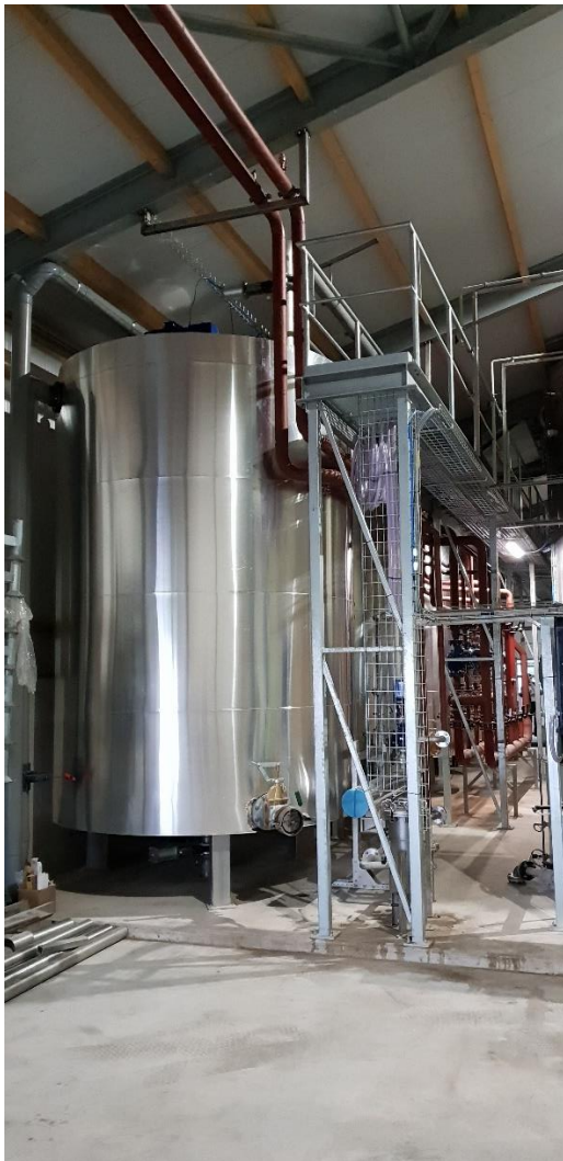
Figuur 5 Pasteurisatietank (één van twee)
