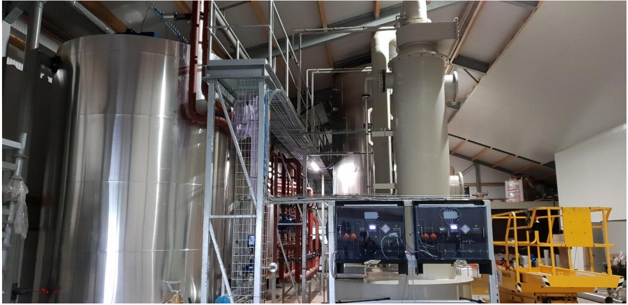
Figuur 4 Pasteurisatietank (één van twee), met rechts chemiedoseringskasten
