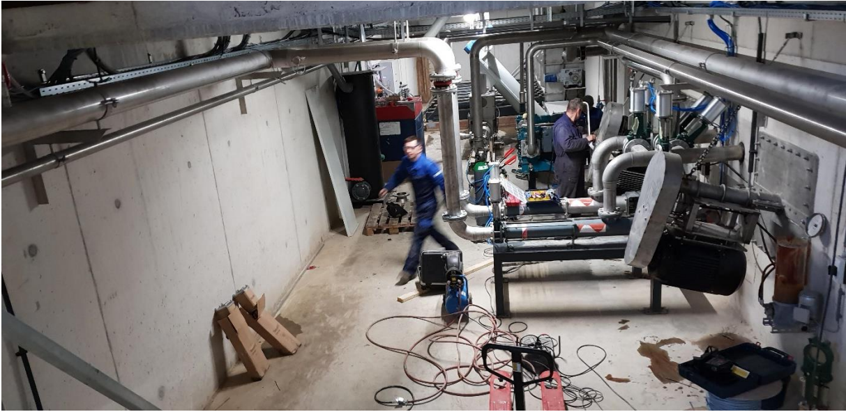
Figuur 9 Meng- en pompkelder (inmengen/verdunnen vaste stof)
