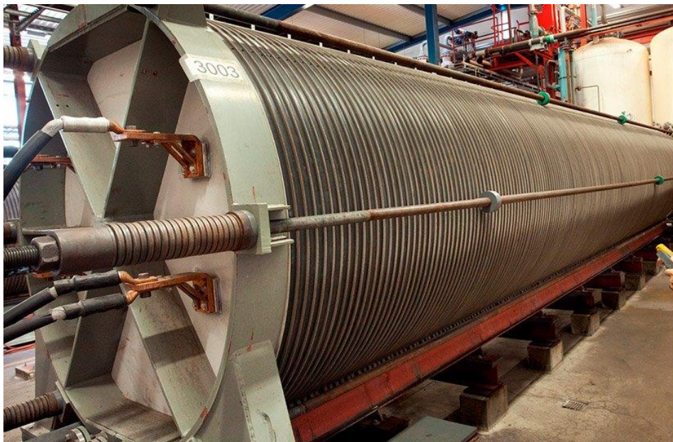
Fig 1: A Nel electrolyser.
