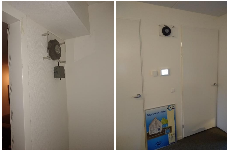
Figuur 10: Mengventilator in de hal op de bg, rechts naast de deur van de woonkamer (links) en 2 e meng-ventilator naast de deur van de woonkamer ten behoeve van metingen (rechts)
