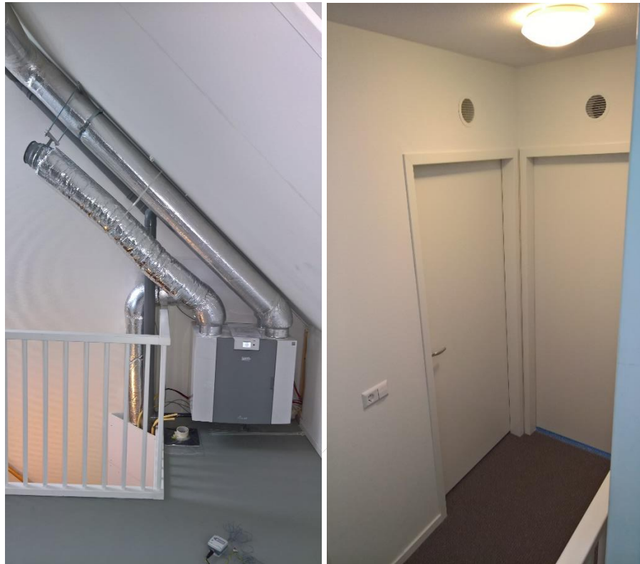
Figuur 1: Warmtewisselaar op zolder met naar linksboven gerichte inblaas van de verse lucht naar de proefwoning boven het trappenhuis (links) en Inblaasopeningen van de overloop naar slaapkamers op de 1e verdieping (rechts)
