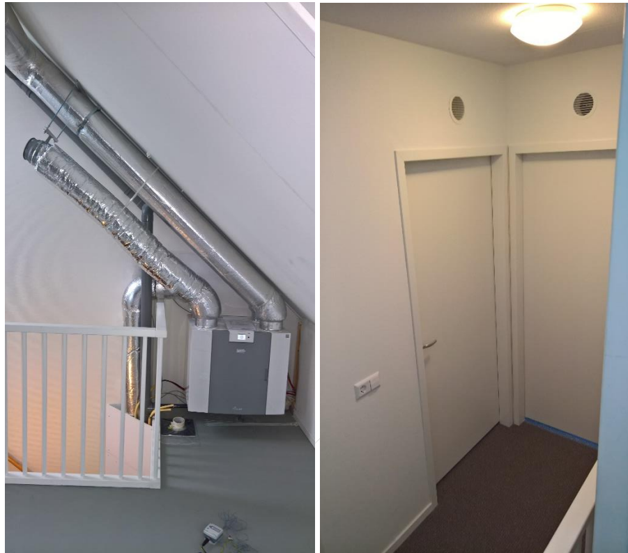
Figuur 9: Warmtewisselaar op zolder met naar linksboven gerichte inblaas van de verse lucht naar de proefwoning boven het trappenhuis (links) en Inblaasopeningen van de overloop naar slaapkamers op de 1e verdieping (rechts)
