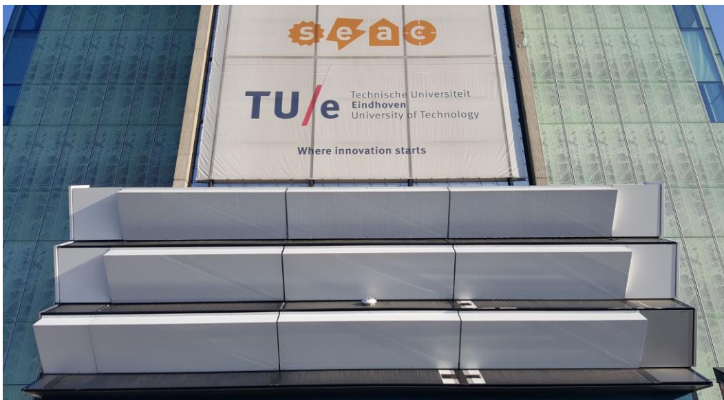
Figuur 5: Prototype ZigZag Solar gevelsysteem. In totaal 3 rijen van 3 ZigZag-cassettes worden ingezet voor diverse onderzoeksvragen. Hiervoor extra sensoren en PV-panelen toegepast (de witte vlakken en schijven) die niet in een commerciële installatie aanwezig zijn.
