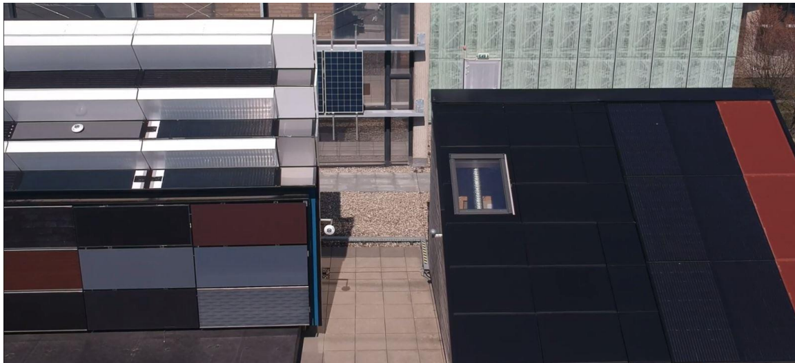
Veldtest karakterisatie van gevelsysteem (links boven) van Wallvision BV, prefab daksysteem (schuin dak, linker dakvlak rondom dakraam) van ReBor BV en gekleurd daksysteem van AERspire BV (schuin dak, rechter dakvlak).
