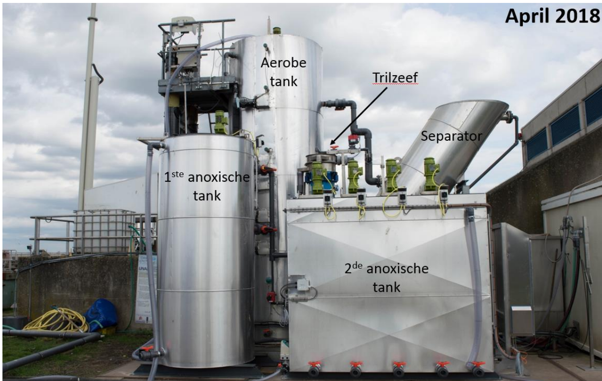
Figuur 1. MAS® pilot installatie.
