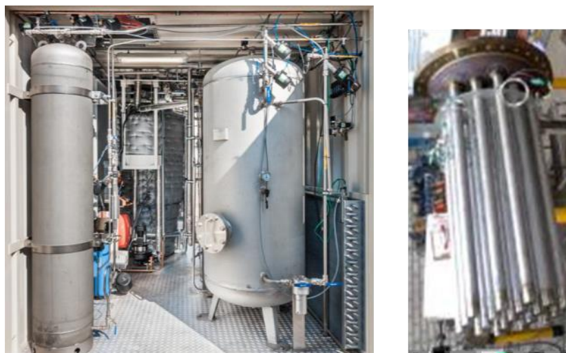
Figuur 6 Links: prototype TCR unit ontwikkeld door CelSian en HyGear. De cilinder links zorgt voor verwijderen zwavel, midden (achterin) is de stoomgenerator en de cilinder rechts bevat de reformer unit. Rechts: binnenwerk van de reformer unit
