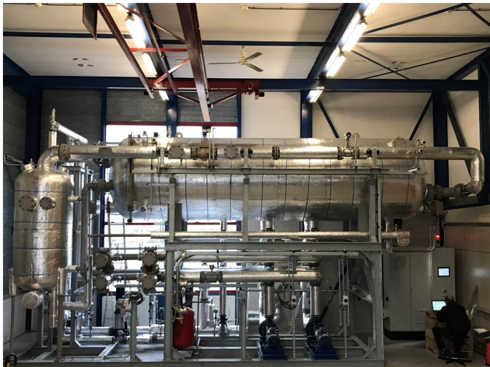
Figuur 16 Foto van de full-scale test rig voor industriële warmtepompen
