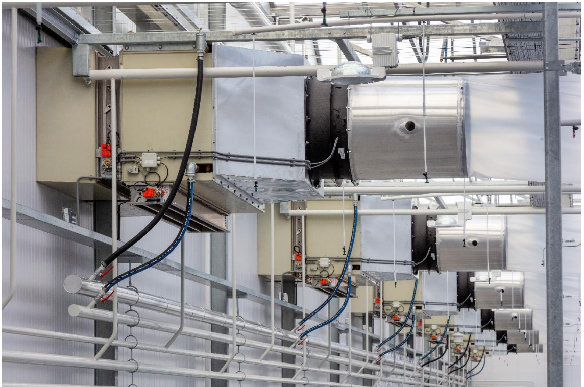
De luchtbehandelingskasten t.b.v. Het Nieuwe Telen
