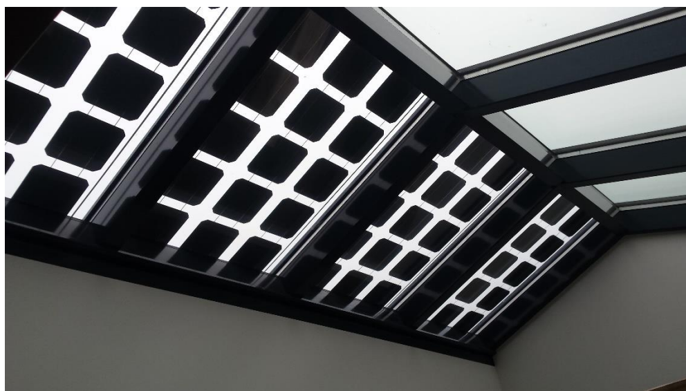
Figuur 2: op maat gemaakte PV modules in lichtstraat bij Serrebouw Brabant
