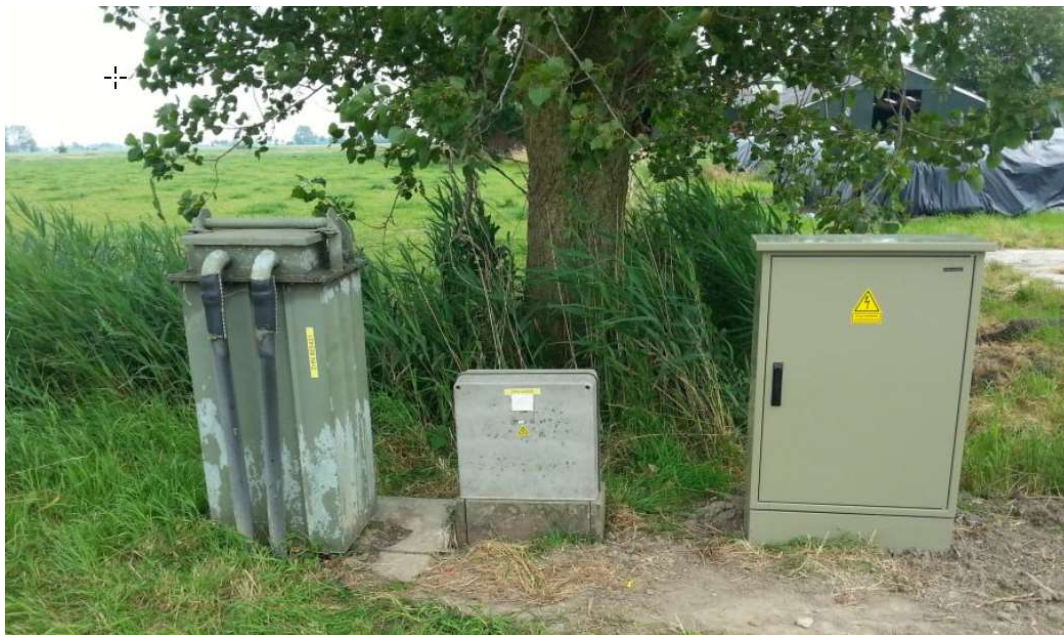
Foto: Voorbeeld LS/LS-spanningsregelaar (links) met 2 laagspanningsverdeelkasten.
