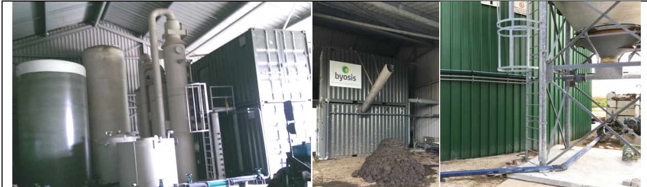
Figuur 4.3 Impressie installatie te Wadstroom na ombouw voor continu bedrijf. Links: buffervat dunne fractie digestaat, ASL-opslag, calciumfosfaatreactoren. Midden: productie van dikke fractie met decanter. Rechts: onderzijde kalksilo
