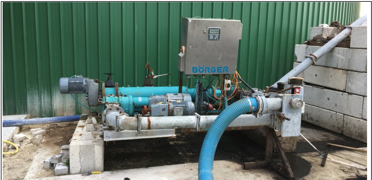
Figuur 3.1 Voorscheiding van digestaat uit de navergister bij Wadstroom via bestaande mestscheider Wadstroom.
