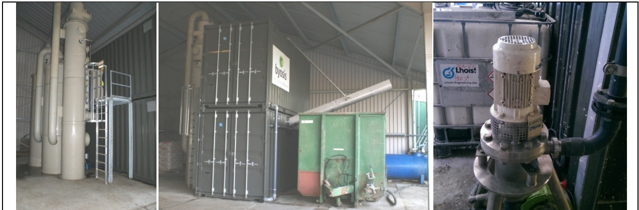
Figuur 4.1 Installatie Wadstroom te Holwerd bij start experimenten eerste testfase. Links : de ByoFlex stripper die in deze fase van het project dienst deed als calciumfosfaat reactor. Midden : een tweetal containers incl. apparatuur voor fosfaatscheiding (modulair ontwerp Byosis). Aan de voorzijde de mestcontainer, tijdelijke opslag van dunne fractie digestaat, afkomstig van de mestscheider. Rechts : Toediening kalkmelk vanuit een IBC.
