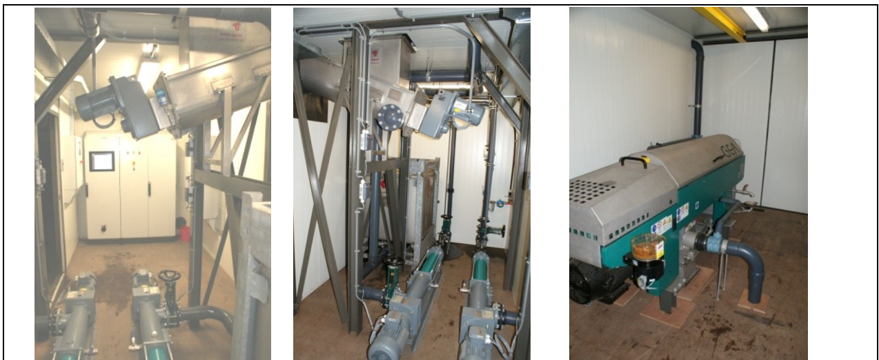
Figuur 4.2 Links : onderste container incl. pompen, dikke fractie vijzel, dunne fractie buffer en besturingskast. Rechts : bovenste container met decanter en hijsbalk.
