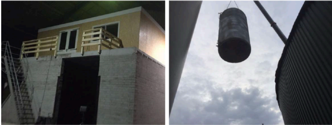
Links: pompenruimte met kantoor/besturingsruimte daarboven Rechts: plaatsing buffertank
