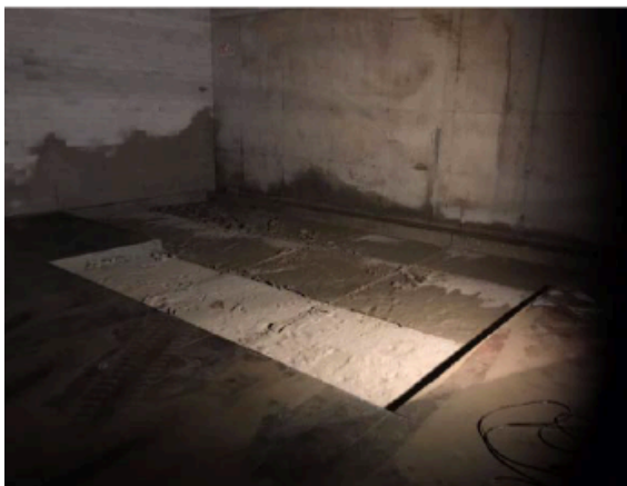
Links: gat gezaagd in de pompruimte voor pompsysteem Rechts: stucen muren pompruimte
